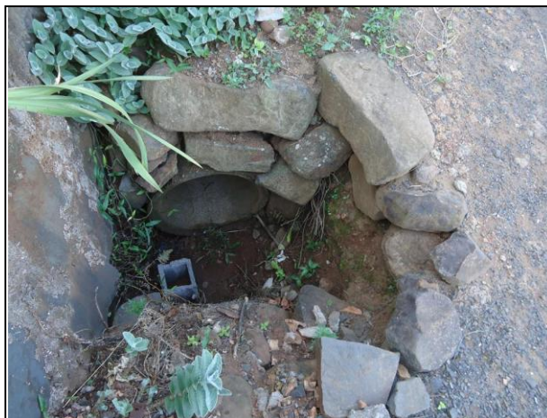
FOTO 03 – Tubulações de Drenagem
