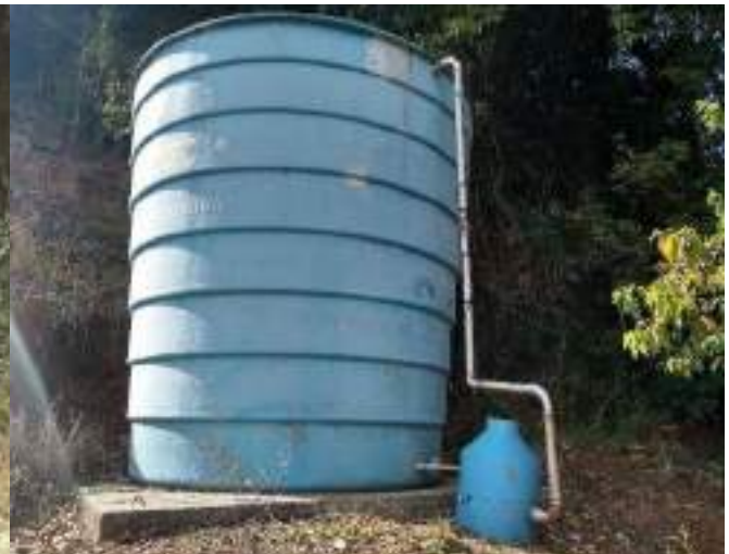
Figura 56: Reservatório R1, com estrutura de cloração
