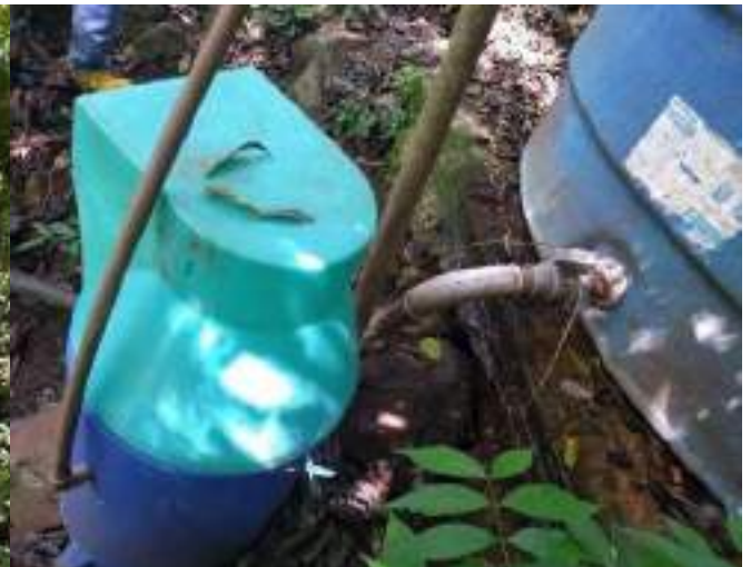
Figura 104: Reservatório R7, com destaque para estrutura de cloração
