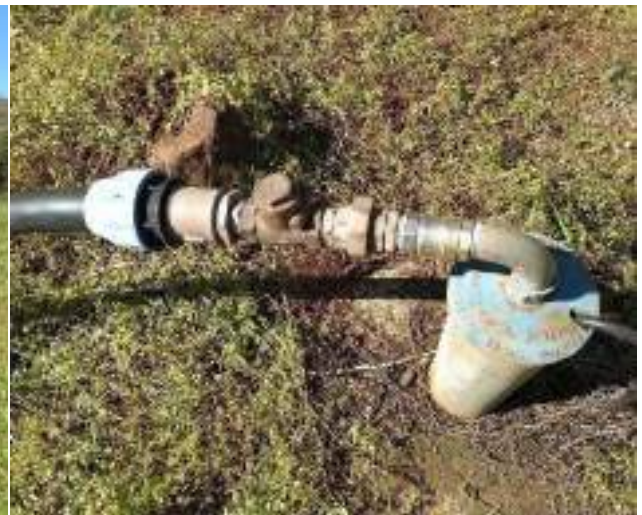
Figura 124: Poço tubular P12, com laje de proteção
