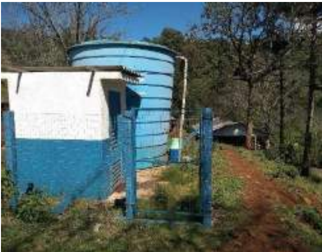
Figura 135: Vista geral do Reservatório R14, estrutura cercada e com controle de acesso
