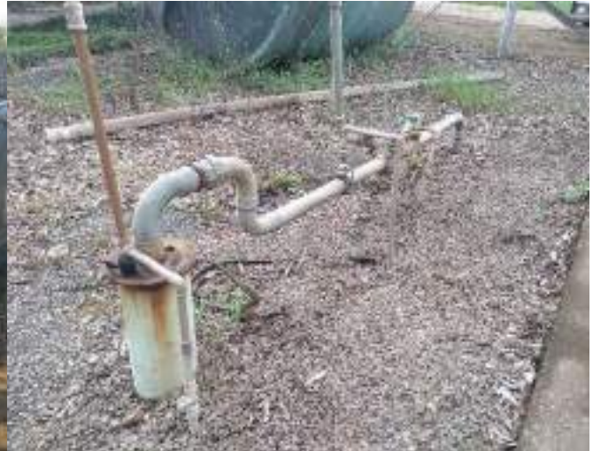
Figura 46: Estrutura do Poço tubular PC3
