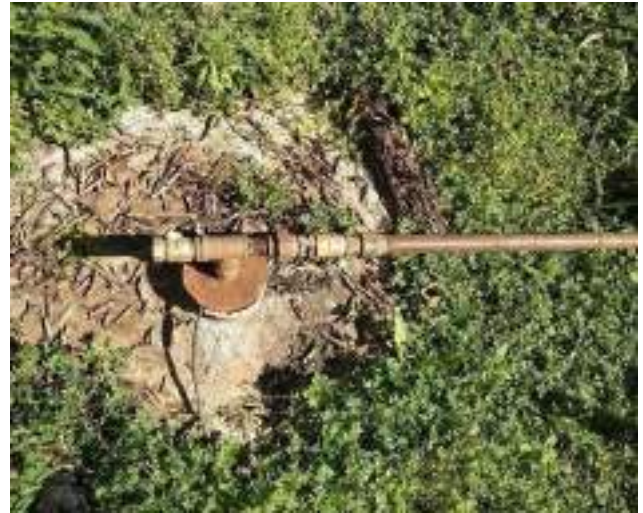
Figura 119: Poço tubular P11, com laje de proteção sanitária
