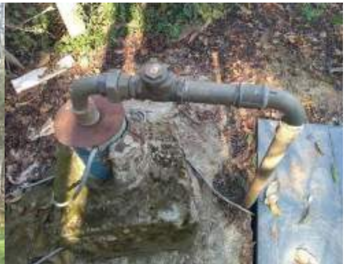
Figura 73: Poço tubular P4, com a presença de laje de proteção
