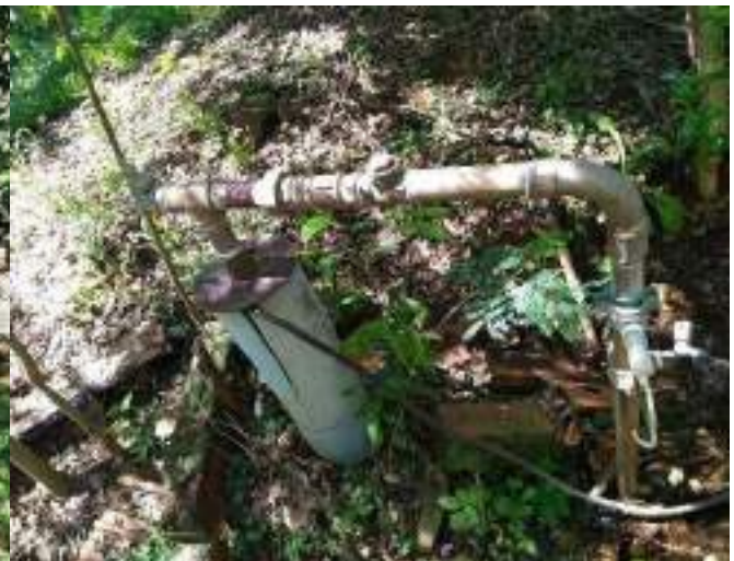
Figura 129: Poço tubular P13, com laje de proteção sanitária
