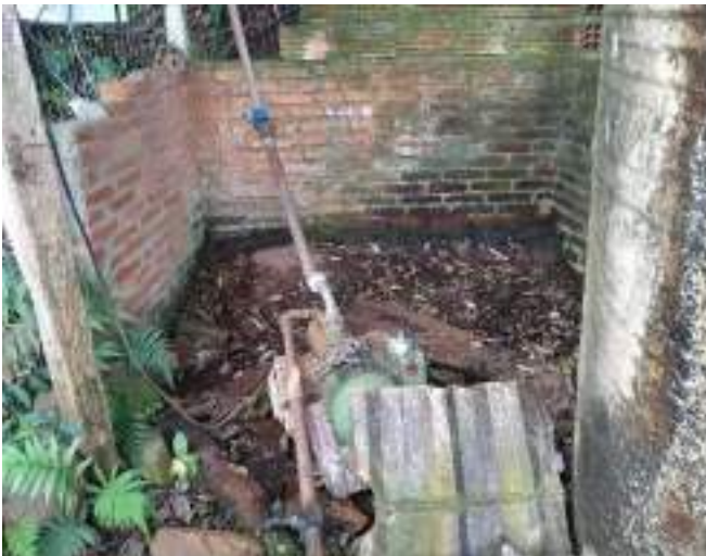
Figura 89: Estrutura de bombeamento presente no Reservatório RF2
