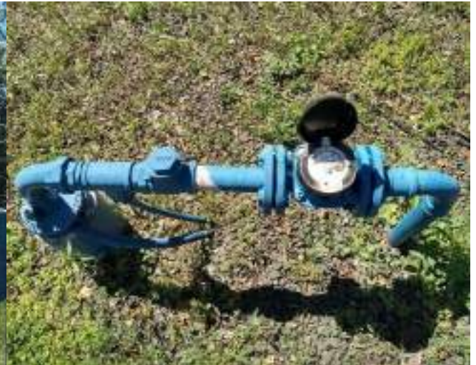
Figura 134: Poço tubular P14, com a presença de hidrômetro
