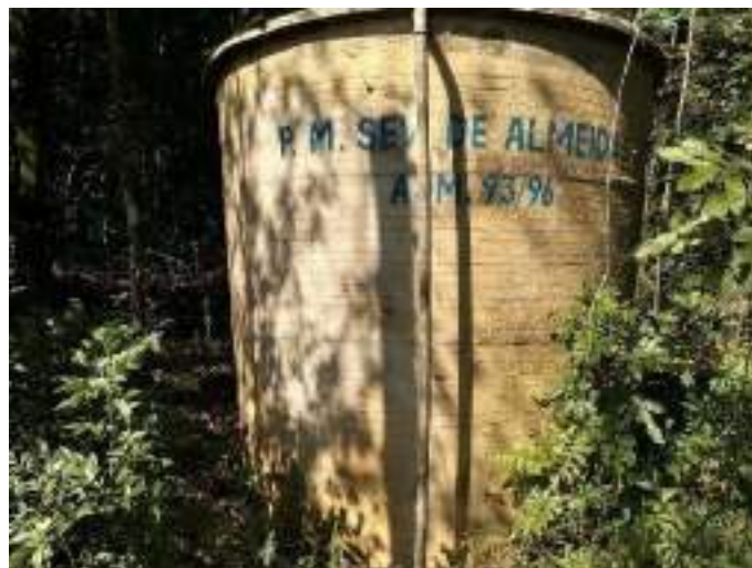
Figura 198: Reservatório R26, sem estrutura para a cloração da água
