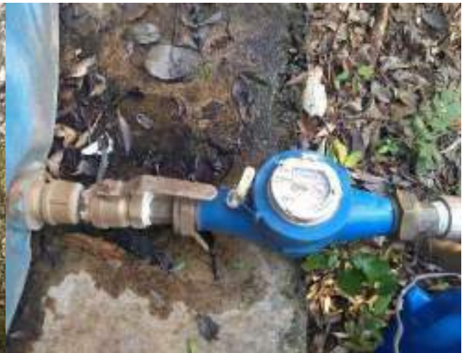
Figura 184: Reservatório R23, com presença de hidrômetro
