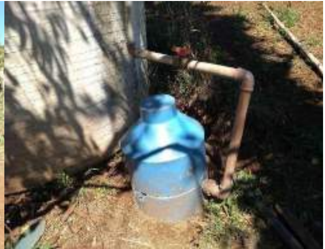
Figura 131: Reservatório R13, destaque para a estrutura de cloração
