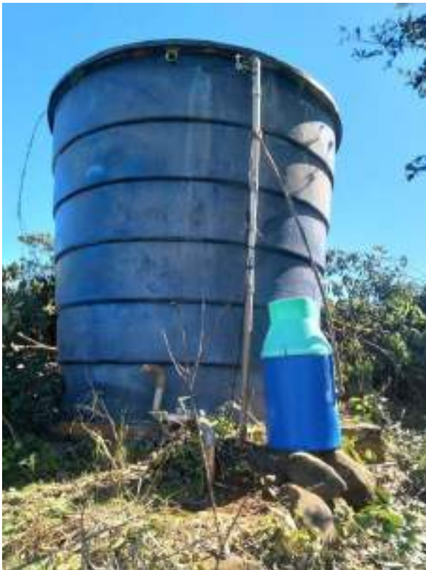
Figura 120: Reservatório R11, com estrutura para a cloração da água
