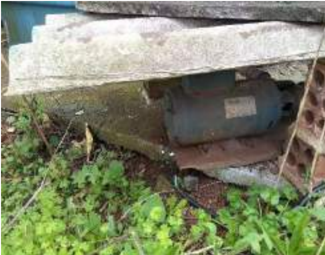
Figura 190: Reservatório recalque Rq24, com presença de bomba para o recalque da água
