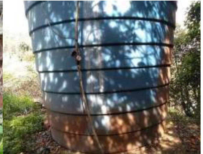
Figura 191: Reservatório recalque Rq24, com presença de hidrômetro na saída do reservatório
