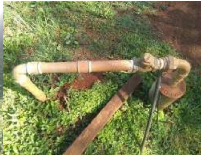
Figura 175: Poço tubular P22, sem a presença de infraestrutura básica
