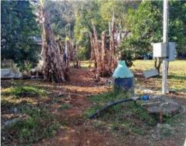
Figura 155: Vista geral do Poço tubular P18, com estrutura para cloração da água desativada
