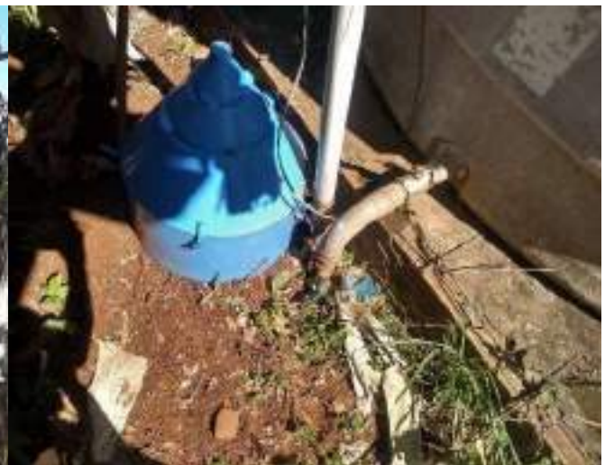
Figura 167: Reservatório R20, com presença de estrutura para a cloração da água
