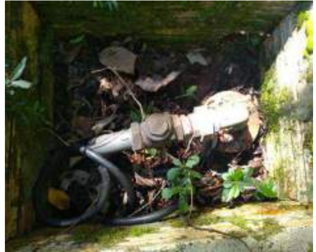
Figura 165: Poço tubular P20, sem a presença de estruturas básicas de controle de captação
