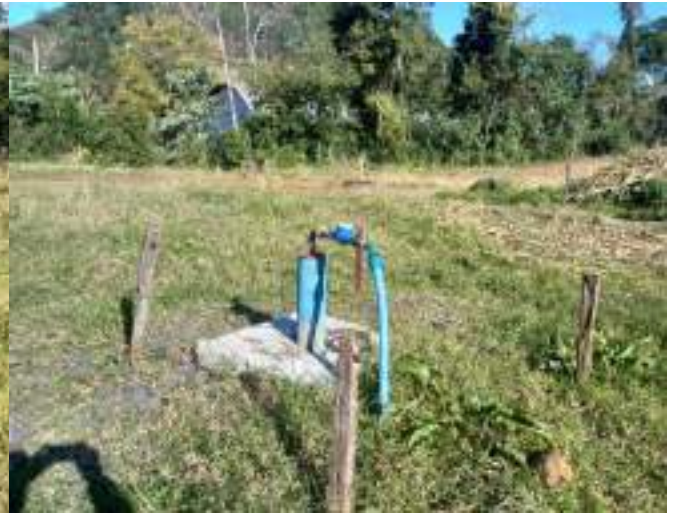
Figura 201: Poço tubular P27, com a presença de laje de proteção e hidrômetro
