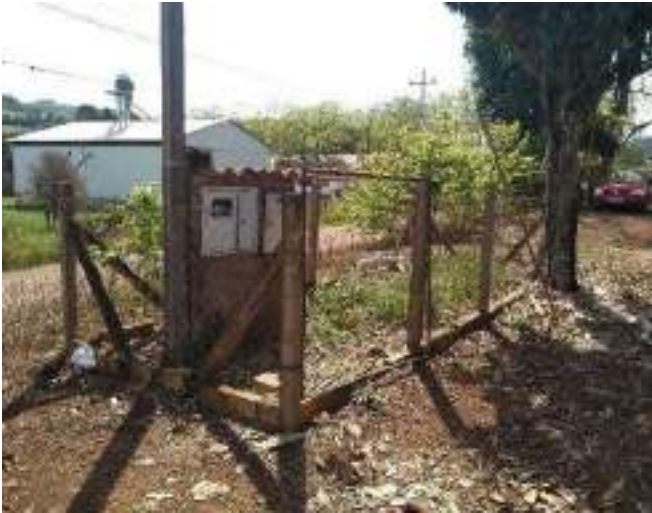
Figura 146: Vista geral do Poço tubular P16, no centro comunitário da Linha Napoleão
