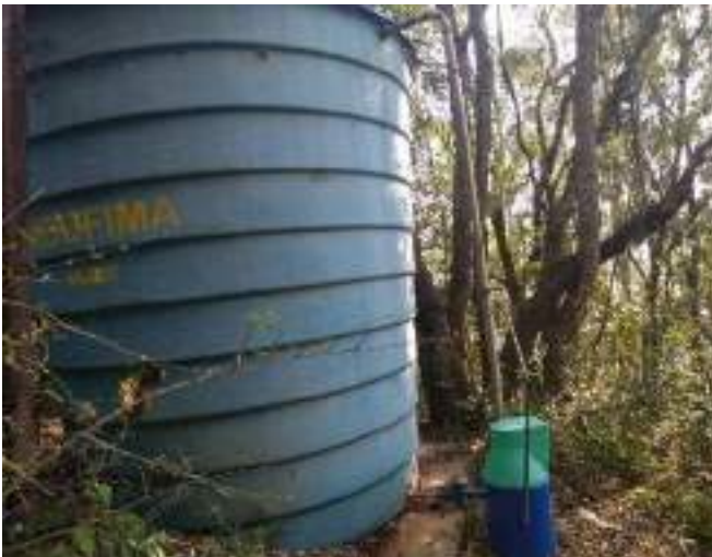
Figura 183: Reservatório R23, com estrutura para a cloração da água
