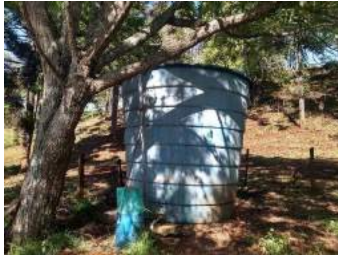
Figura 116: Reservatório R10, com estrutura para realizar o processo de cloração da água
