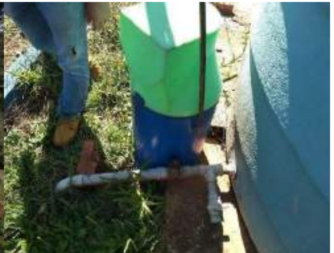
Figura 136: Reservatório R14, com presença de estrutura para a cloração da água
