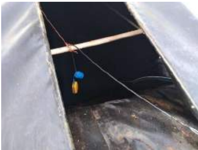
Figura 91: Área de inspeção da Cisterna CF2, com presença de boia para controle de nível
