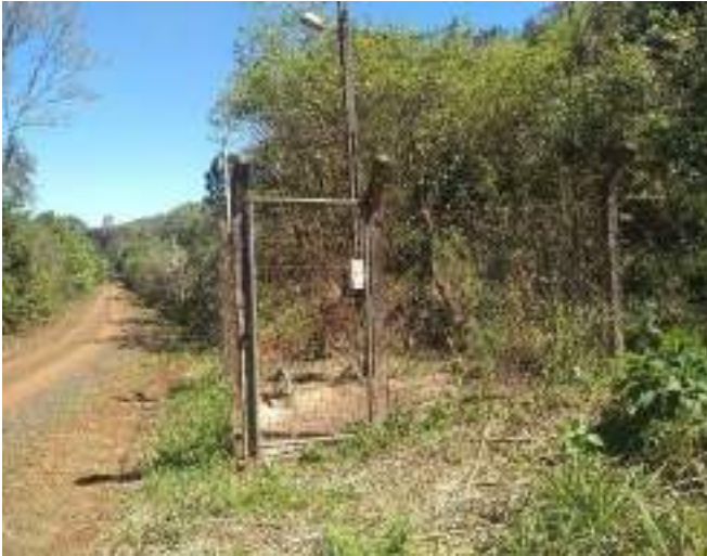
Figura 160: Vista geral do Poço tubular P19, com cercamento e controle de acesso
