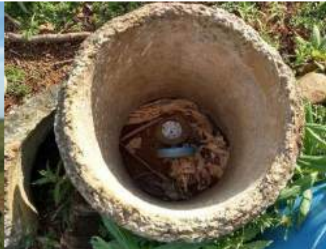
Figura 177: Reservatório R22, com presença de hidrômetro
