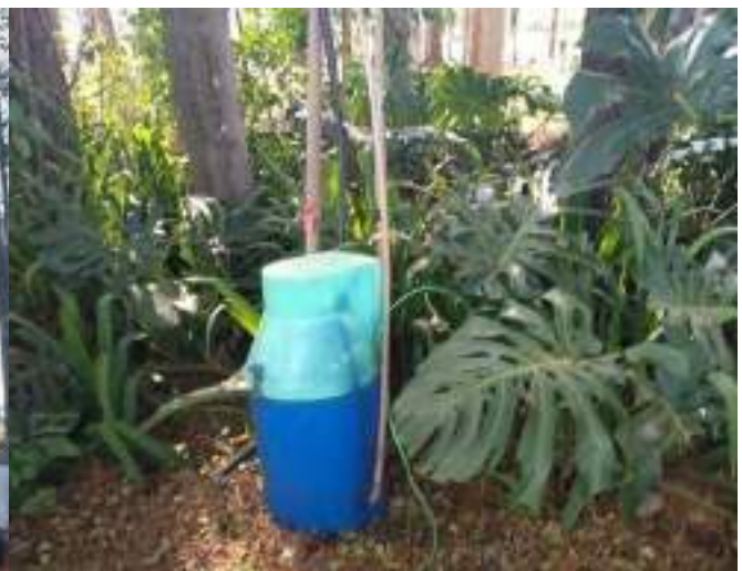
Figura 85: Reservatório R6, com destaque para estrutura de cloração
