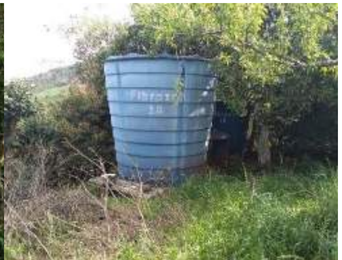
Figura 189: Reservatório recalque Rq24, próximo à área de cultivo de cítricos
