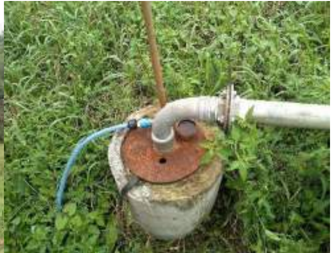
Figura 42: Estrutura de captação do poço tubular PC2
