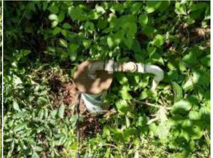
Figura 170: Poço tubular P21, com presença de laje de proteção
