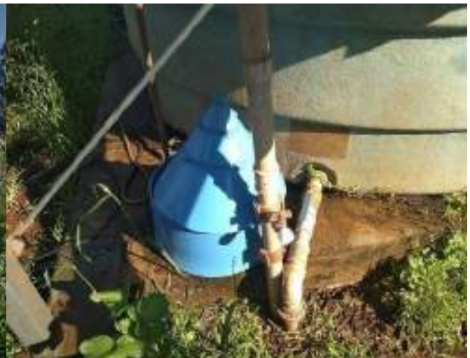
Figura 75: Reservatório R4, com destaque para a estrutura de cloração
