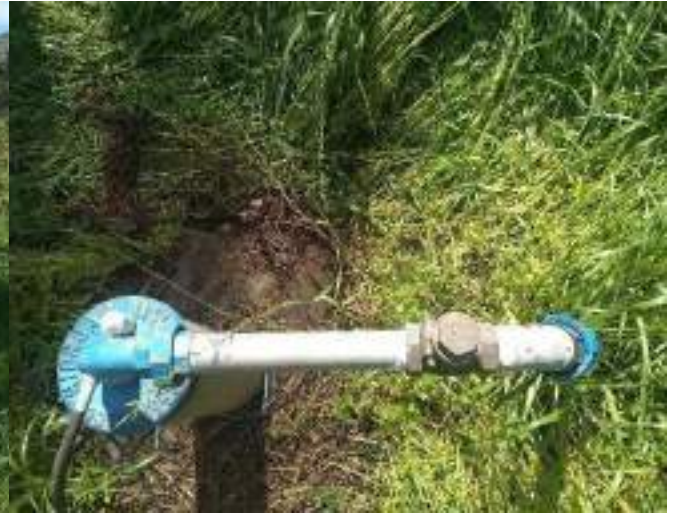
Figura 112: Poço tubular P9, com laje de proteção e tubo de medição de nível
