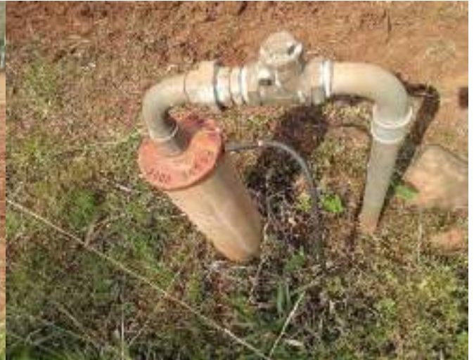
Figura 187: Poço tubular P24, sem presença de infraestrutura básica
