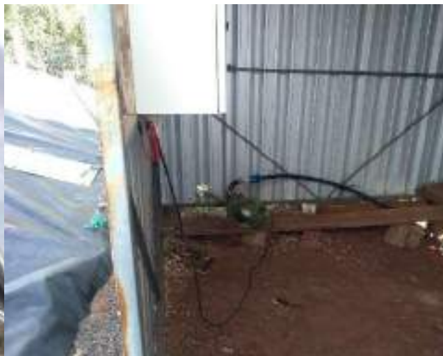
Figura 92: Sistema de bombeamento presente na Cisterna CF2
