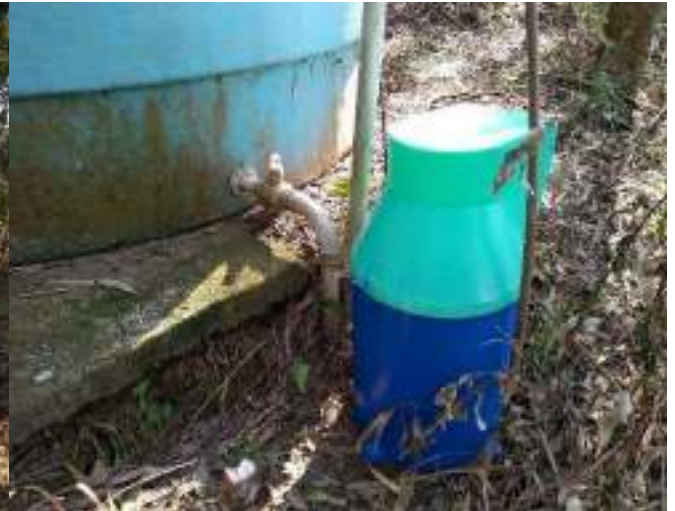
Figura 209: Reservatório R28, com a presença de estrutura para a cloração da água
