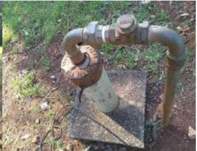
Figura 182: Poço tubular P23, com a presença de laje de proteção
