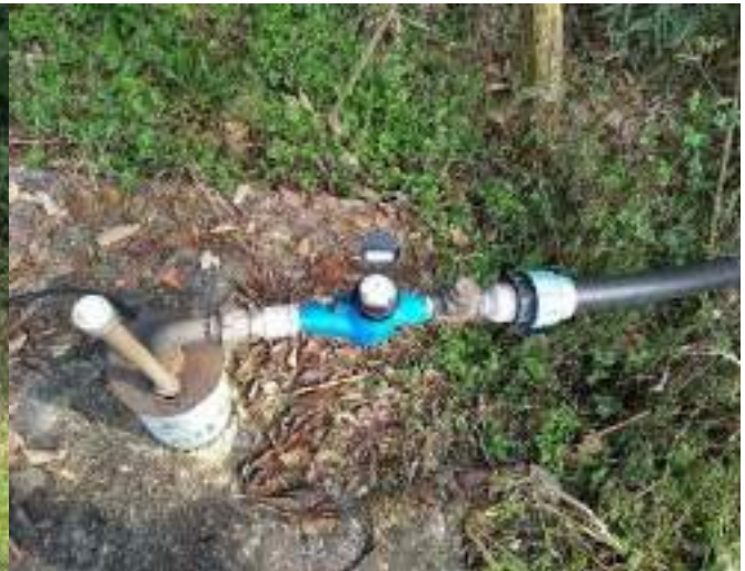
Figura 63: Poço tubular P2, com laje de proteção, hidrômetro e tubo de medição de nível
