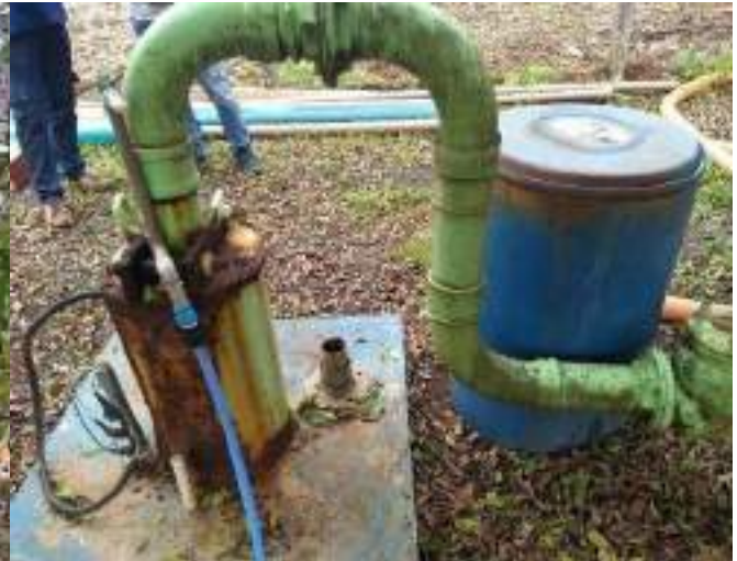
Figura 38: Poço tubular PC1, com presença de laje de proteção
