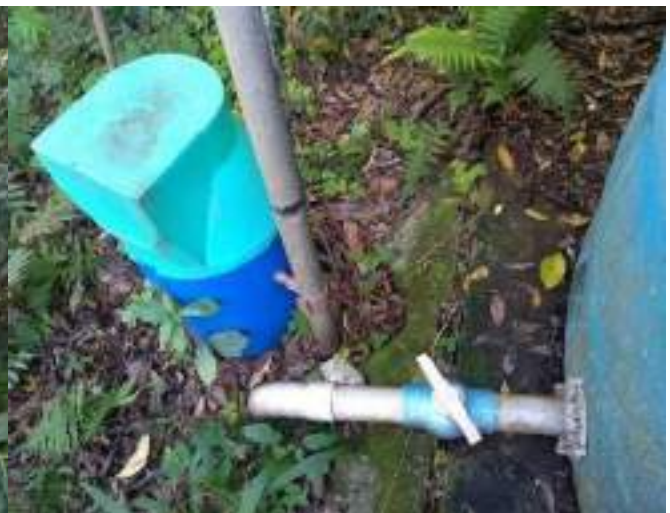
Figura 126: Reservatório R12, com destaque para a estrutura de cloração
