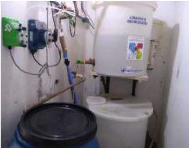
Figura 39: Vista geral do espaço destinado aos processos de cloração e fluoretação da água
