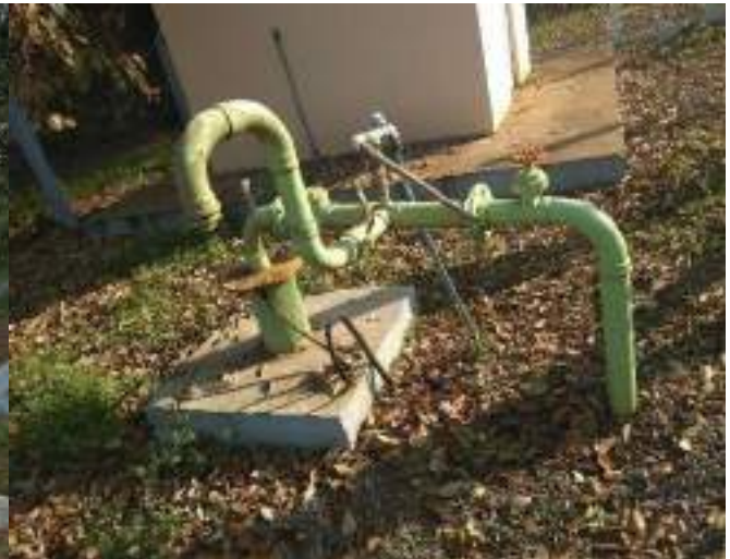
Figura 49: Estrutura do Poço tubular PC4
