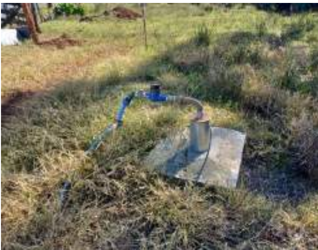
Figura 193: Vista geral do Poço tubular P25
