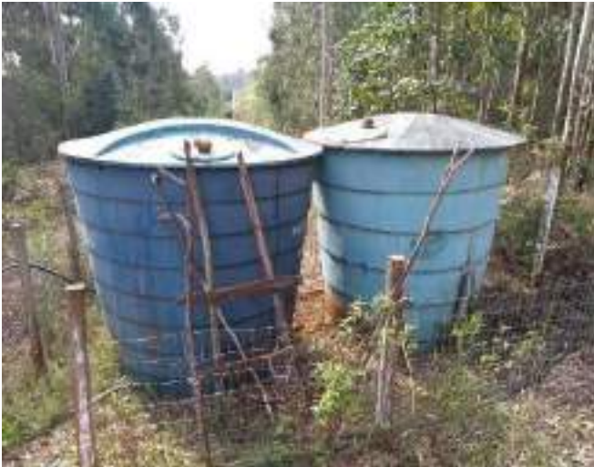
Figura 96: Reservatório RrF3, com cercamento e controle de acesso
