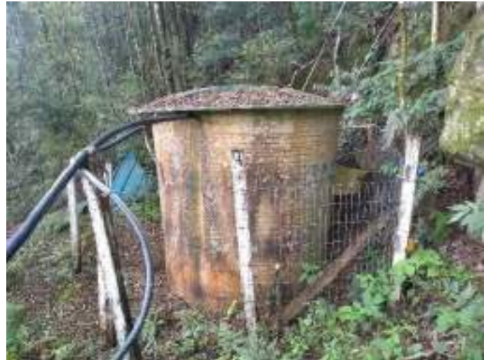
Figura 88: Reservatório RF2, com cercamento
