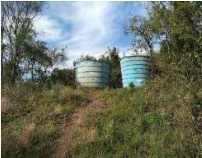
Figura 98: Reservatório RF3, localizado às margens da BR-153
