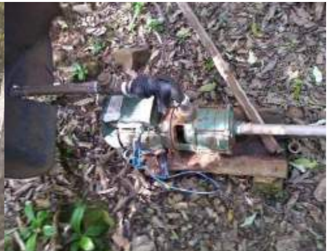
Figura 95: Estrutura de bombeamento presente no Reservatório RqF3
