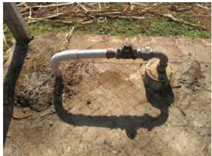
Figura 207: Poço tubular P28, com a presença de laje de proteção
