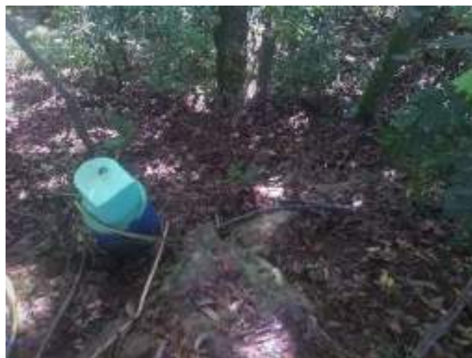
Figura 60: Estrutura de tratamento por cloração da água captada pela Fonte drenada F1
