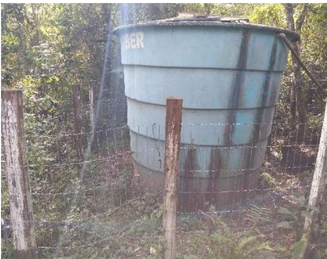
Figura 94: Reservatório RqF3, com cercamento e controle de acesso
