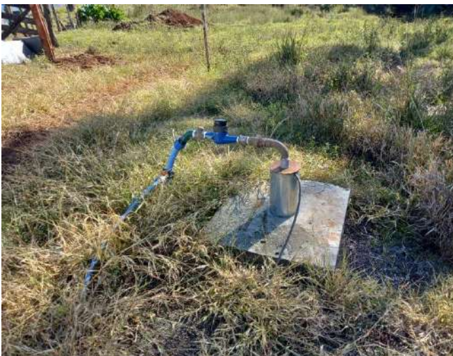
Figura 193: Vista geral do Poço tubular P25
