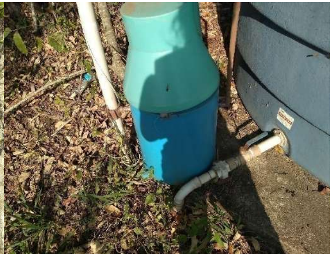
Figura 158: Reservatório R18, com estrutura para cloração da água
