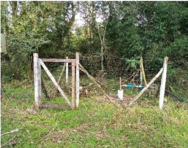
Figura 62: Vista geral do Poço tubular P2, com cercamento e controle de acesso
