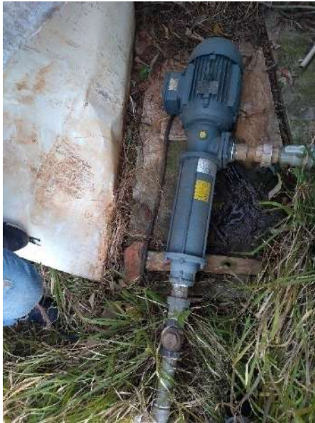
Figura 143: Reservatório recalque Rq15, presença de bomba de recalque de água
