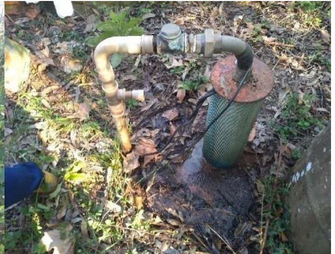
Figura 78: Poço tubular P5, com laje de proteção e saída para coleta de água bruta
