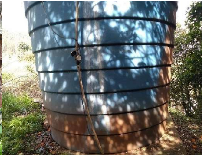
Figura 191: Reservatório recalque Rq24, com presença de hidrômetro na saída do reservatório
