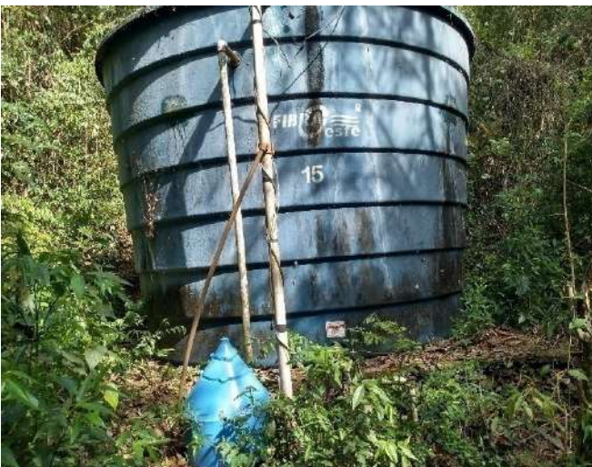
Figura 188: Reservatório R24, com estrutura para a cloração da água
