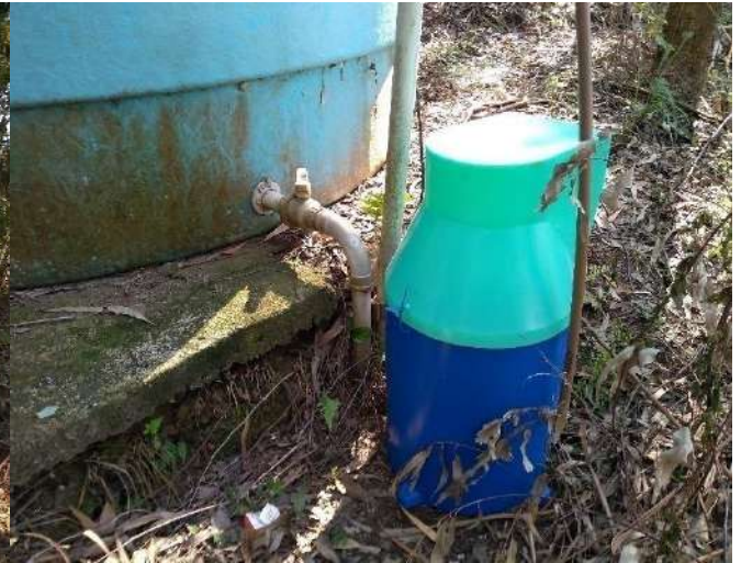
Figura 209: Reservatório R28, com a presença de estrutura para a cloração da água
