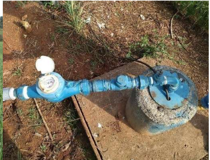
Figura 54: Poço tubular P1, com hidrômetro e laje de proteção
