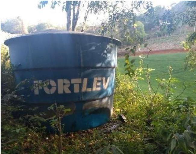
Figura 178: Vista geral do Reservatório Rd22, próximo a uma área de produção agrícola
