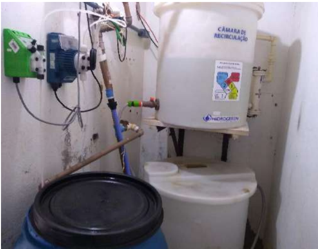
Figura 39: Vista geral do espaço destinado aos processos de cloração e fluoretação da água
