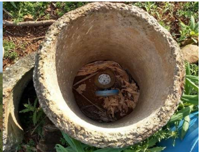
Figura 177: Reservatório R22, com presença de hidrômetro
