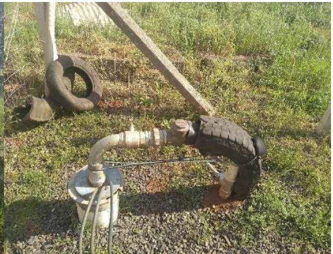
Figura 83: Poço tubular P6, acionado em eventos de escassez hídrica
