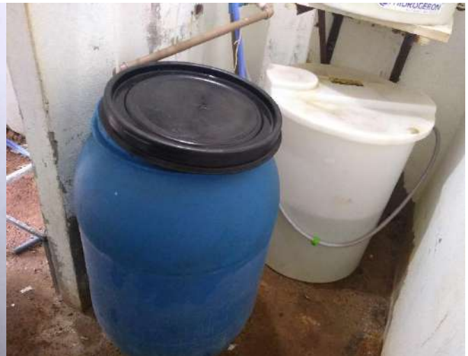
Figura 40: Tambores de armazenamento de soluções para o tratamento da água
