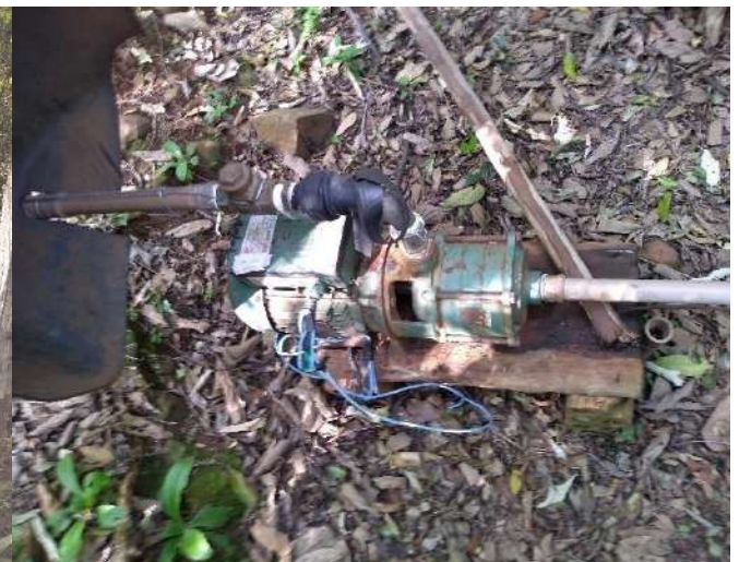
Figura 95: Estrutura de bombeamento presente no Reservatório RqF3
