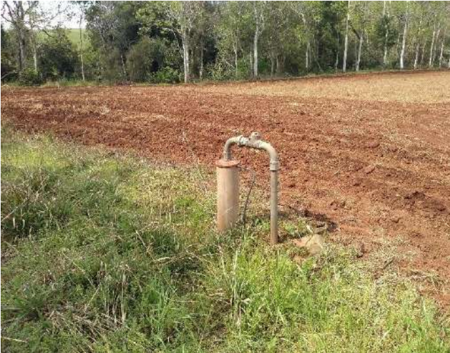
Figura 186: Vista geral do Poço tubular P24, próximo a uma área agrícola
