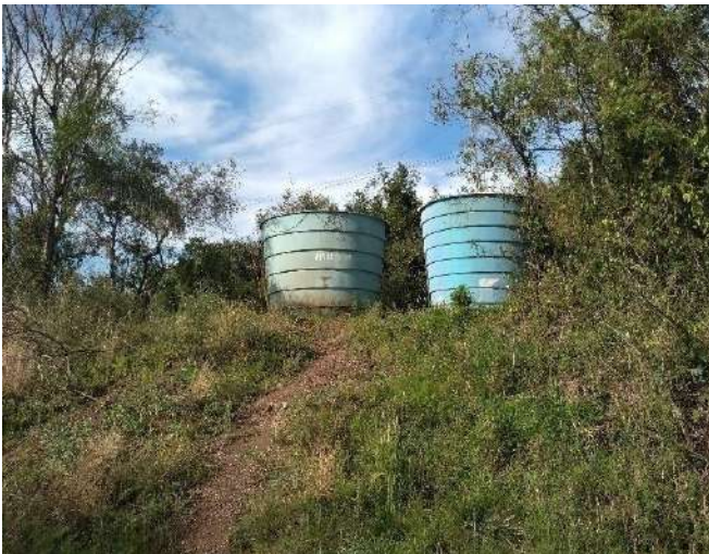
Figura 98: Reservatório RF3, localizado às margens da BR-153
