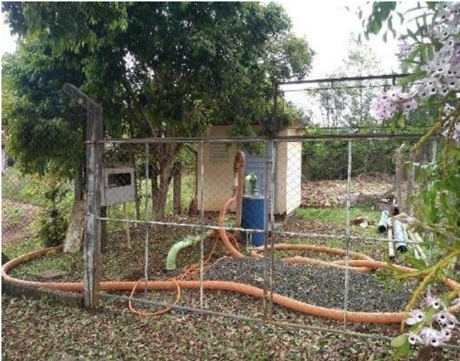
Figura 37: Vista geral do Poço tubular PC1 (R. Jandir Zanella)
