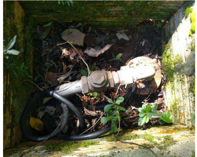
Figura 165: Poço tubular P20, sem a presença de estruturas básicas de controle de captação
