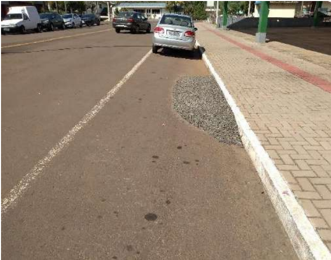
Figura 237: Configuração de rampa que impede a livre circulação da água pluvial pela sarjeta
