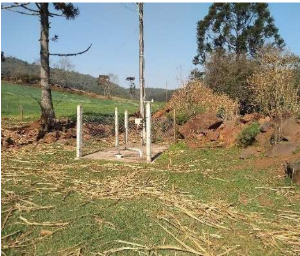
Figura 206: Vista geral do Poço tubular P28, com cercamento e controle de acesso
