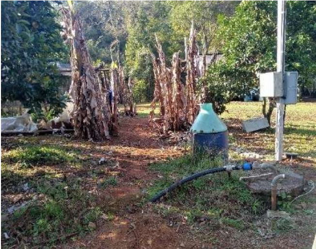
Figura 155: Vista geral do Poço tubular P18, com estrutura para cloração da água desativada
