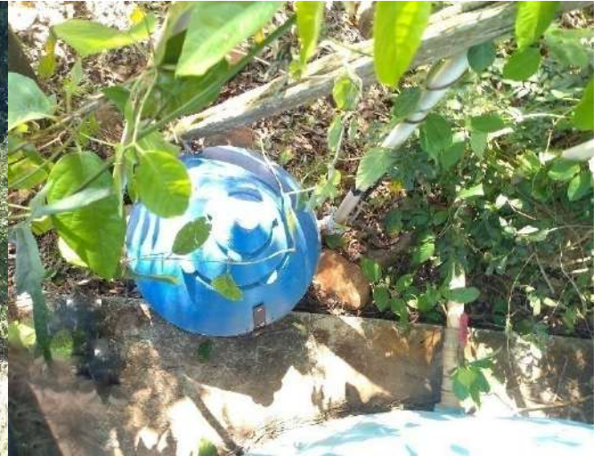
Figura 172: Reservatório R21, com destaque para a estrutura de cloração
