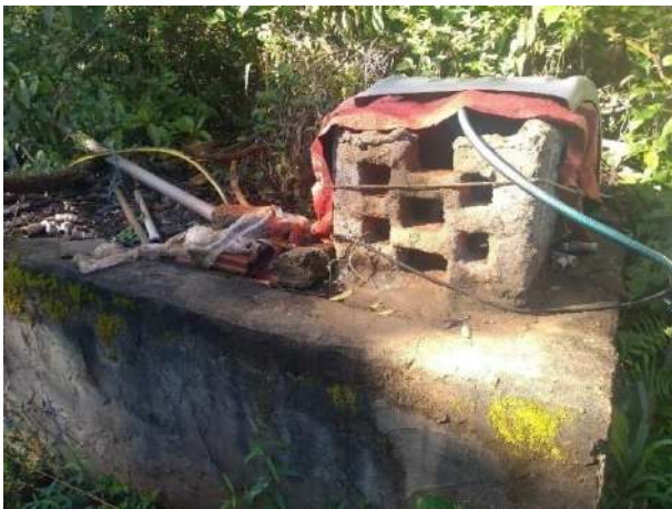
Figura 58: Instalações de armazenamento e bombeamento da água captada pela Fonte F1
