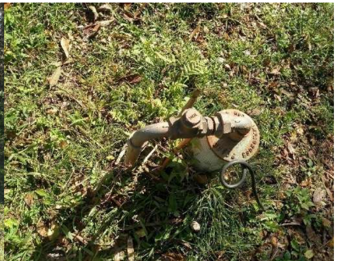
Figura 115: Poço tubular P10, com ausência de infraestrutura básica
