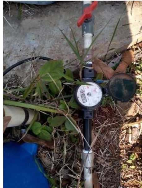
Figura 144: Reservatório recalque Rq15, presença de hidrômetro na saída do reservatório
