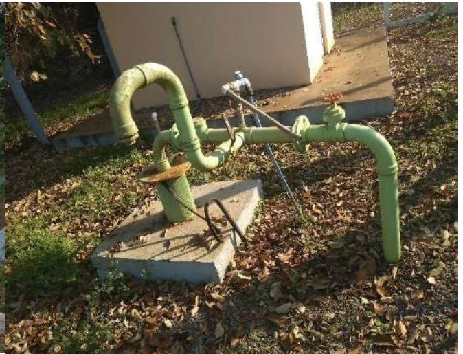
Figura 49: Estrutura do Poço tubular PC4
