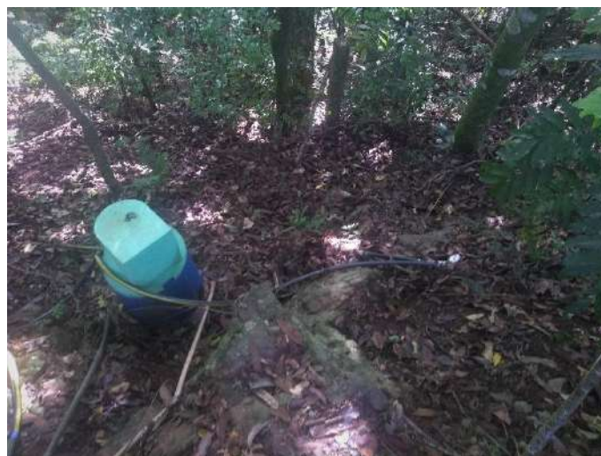
Figura 60: Estrutura de tratamento por cloração da água captada pela Fonte drenada F1
