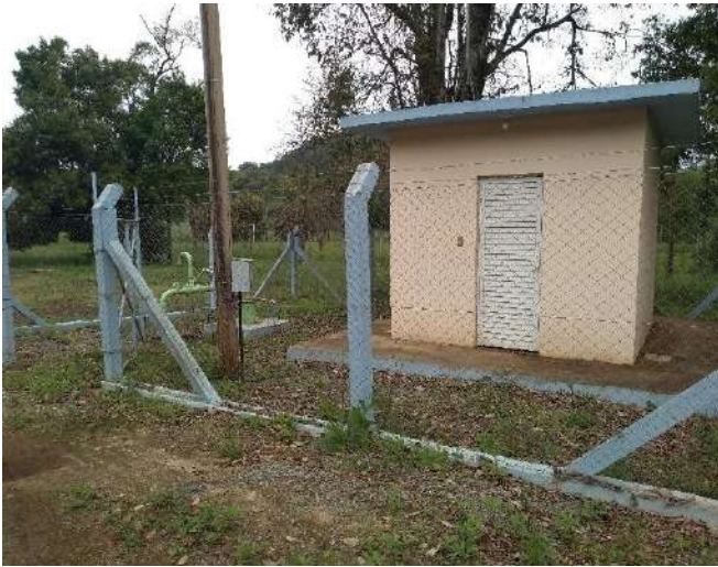
Figura 48: Vista geral do Poço tubular PC4, com controle de acesso e cercamento
