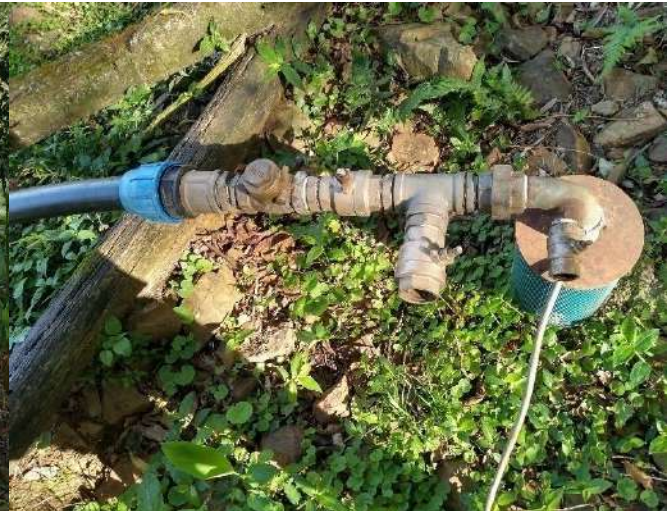
Figura 151: Poço tubular P17, com ausência de infraestrutura básica
