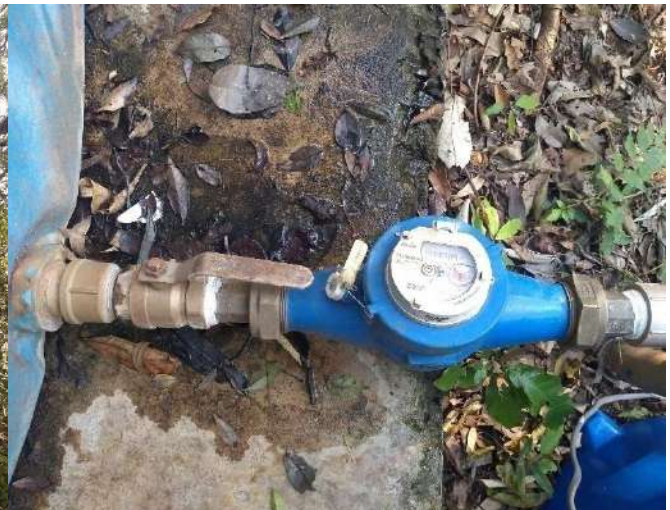
Figura 184: Reservatório R23, com presença de hidrômetro
