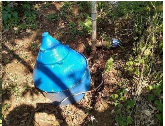
Figura 203: Reservatório Rd27, com estrutura anexa para cloração da água
