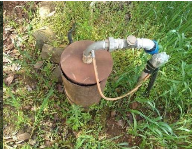
Figura 68: Poço tubular P3, sem a presença de infraestrutura básica
