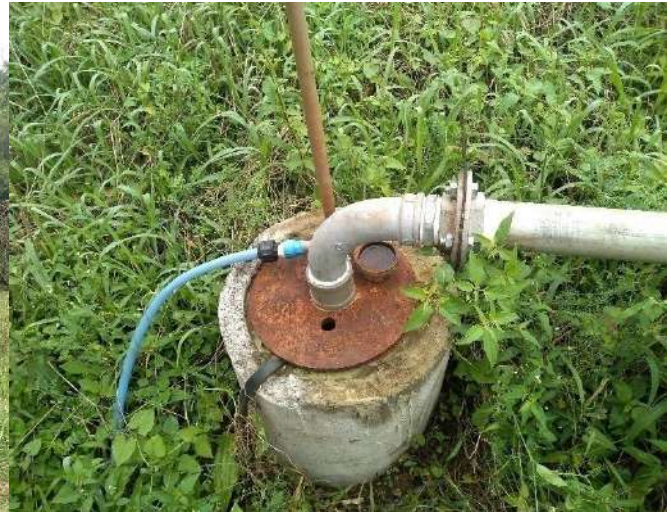
Figura 42: Estrutura de captação do poço tubular PC2
