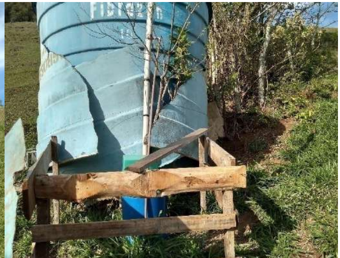
Figura 153: Reservatório R17, com estrutura responsável pela cloração da água
