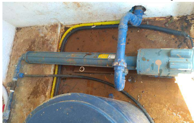
Figura 137: Sistema de bombeamento presente no Reservatório R14
