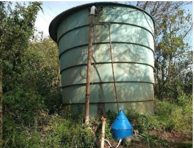
Figura 99: Reservatório RF3, com presença de estrutura de cloração da água
