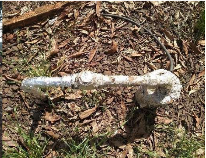
Figura 147: Poço tubular P16, com ausência de hidrômetro e laje de proteção
