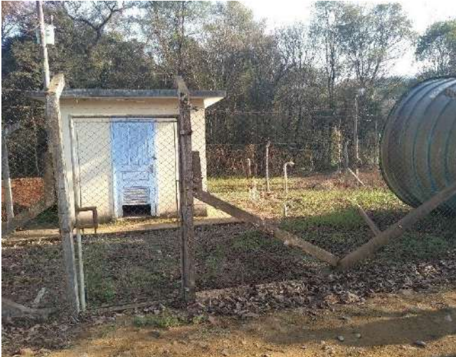
Figura 45: Vista geral do poço tubular PC3, com controle de acesso e cercamento
