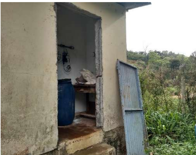
Figura 43: Instalações destinadas ao tratamento da água do PC2
