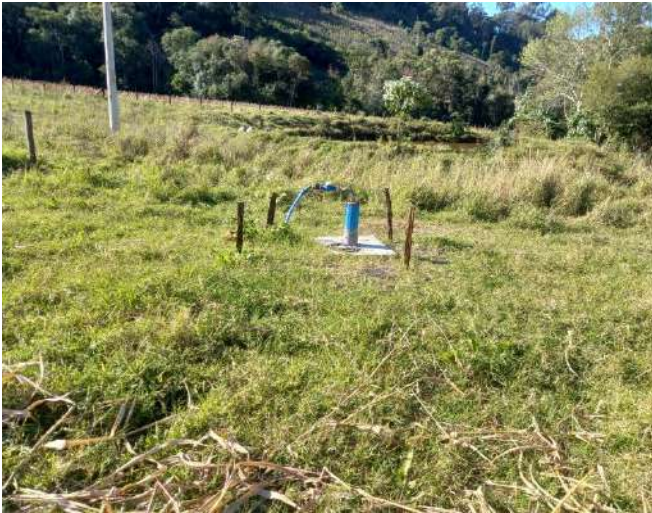
Figura 200: Vista geral do Poço tubular P27
