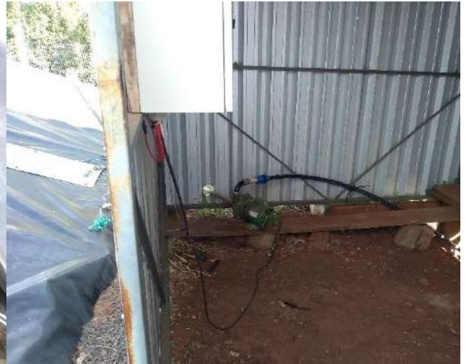
Figura 92: Sistema de bombeamento presente na Cisterna CF2
