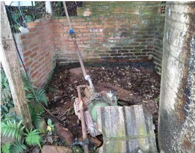
Figura 89: Estrutura de bombeamento presente no Reservatório RF2
