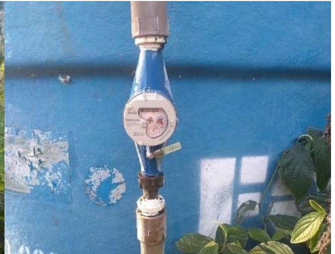
Figura 179: Reservatório Rd22, com a presença de hidrômetro
