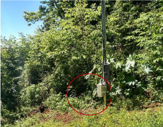
Figura 169: Vista geral do Poço tubular P 21, próximo a um fragmento florestal
