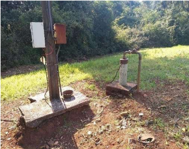
Figura 181: Vista geral do Poço tubular P23
