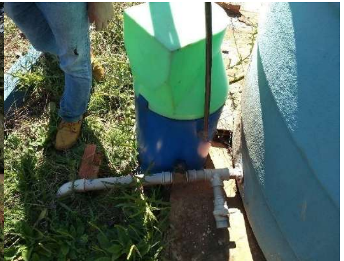
Figura 136: Reservatório R14, com presença de estrutura para a cloração da água
