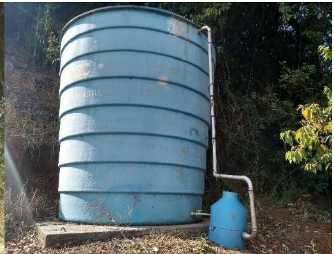
Figura 56: Reservatório R1, com estrutura de cloração
