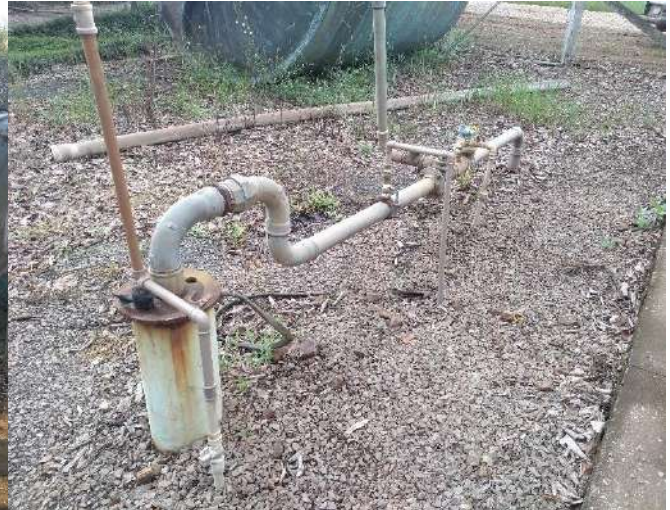
Figura 46: Estrutura do Poço tubular PC3
